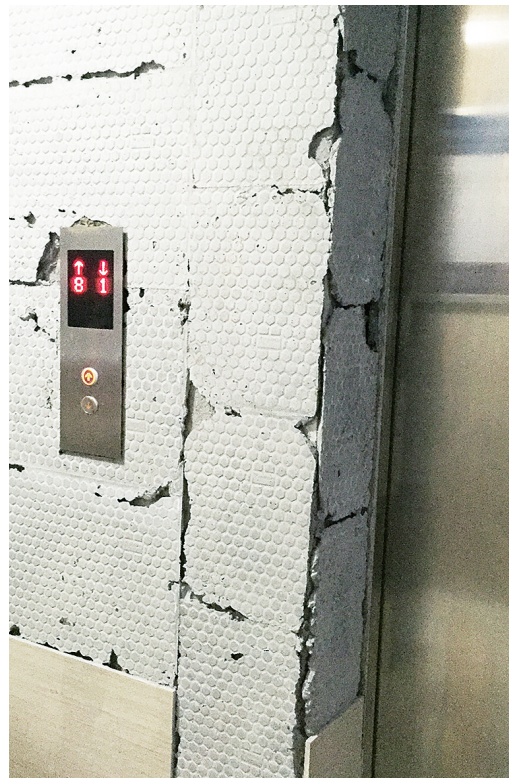
瓷砖脱落后的墙体。
