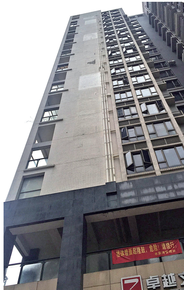
水蓝湾小区一栋出现墙体脱落现象的居民楼。
