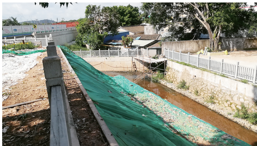
木古河II标15号节点进行生态式护坡施工。龙岗区环境保护和水务局项目组供图
