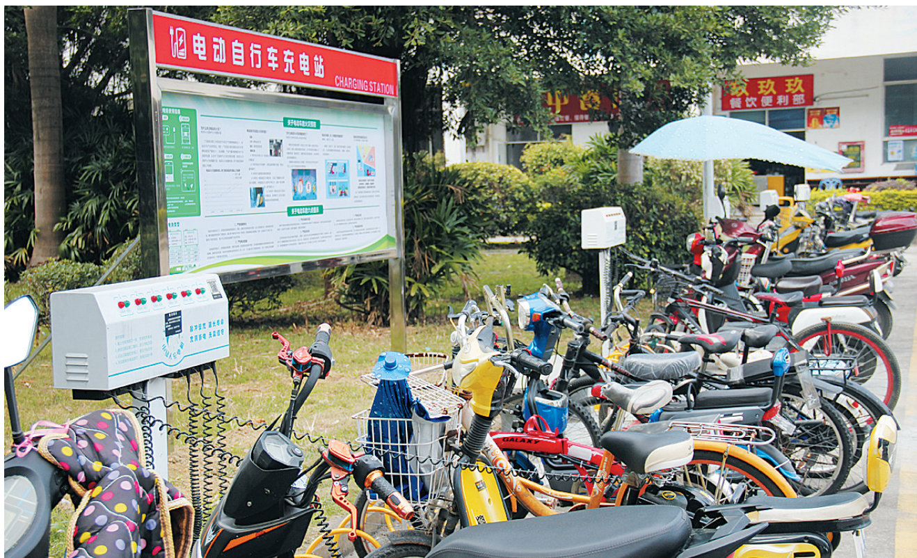
大鹏新区建成的充电桩均已投入使用。
