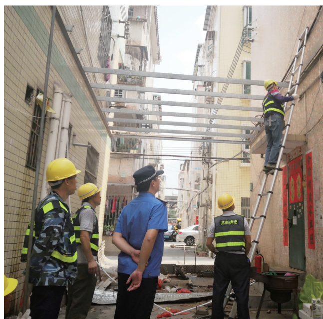
龙岗街道整治城中村乱搭建,消除安全隐患。
