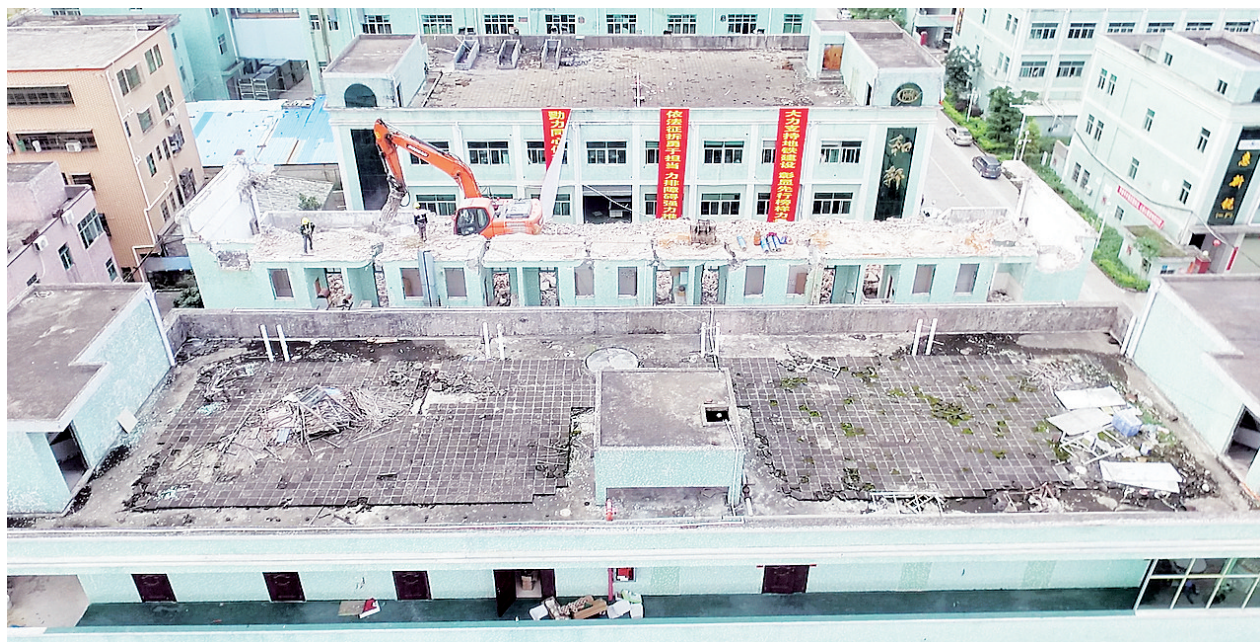
16号线田心车辆段集体厂房拆除现场。侨报融媒通讯员 蔡传河 摄
