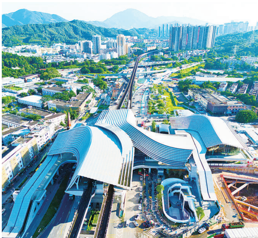
龙岗大道大运枢纽段下沉工程施工现场。龙岗融媒记者 张臻斐 摄
