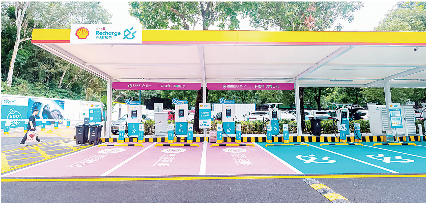
龙岗海关大厦超充示范站。
