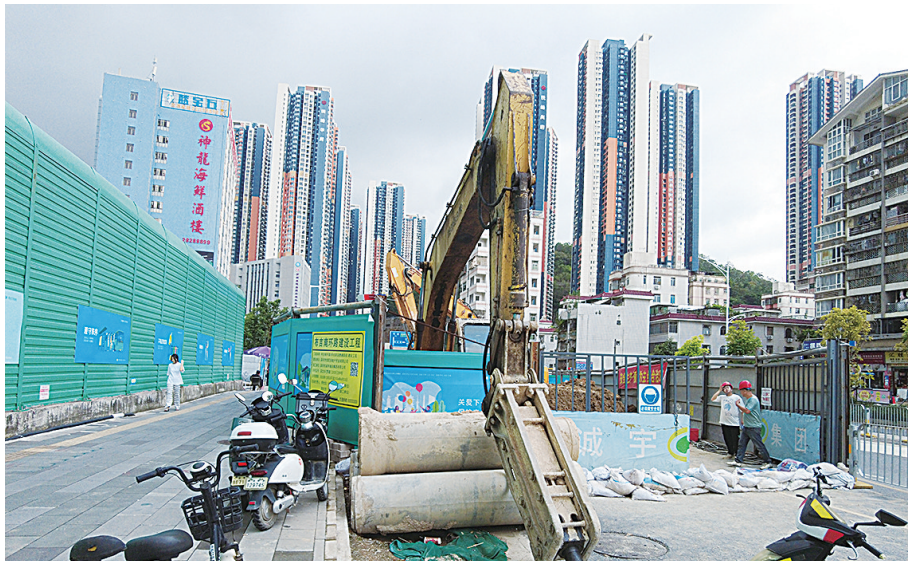
施工现场环境杂乱。
